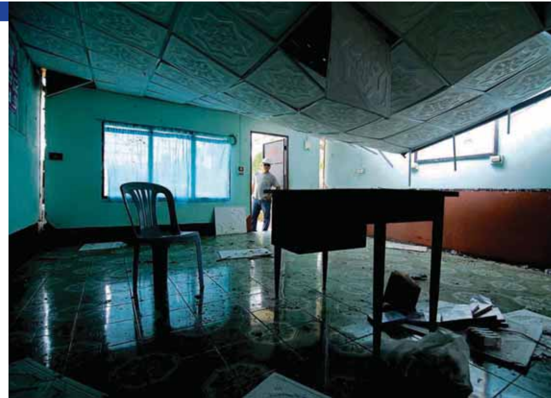
สภาพภายในอาคารโรงเรียนบ้านทุ่งฟ้าผ่า หมู่ ๘ ตำบลแม่พริก อำเภอแม่สรวย ที่เสียหายหนัก ก่อนประกาศ และพบรอยแตกตามเสาจำนวนมาก จนต้องปิดการเรียนการสอน
